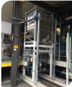
Container- Entleerstation mit DASAG-Pulverpumpe
