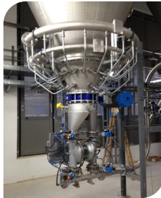
Siloaustragsystem mit DASAG- Pulverpumpe
